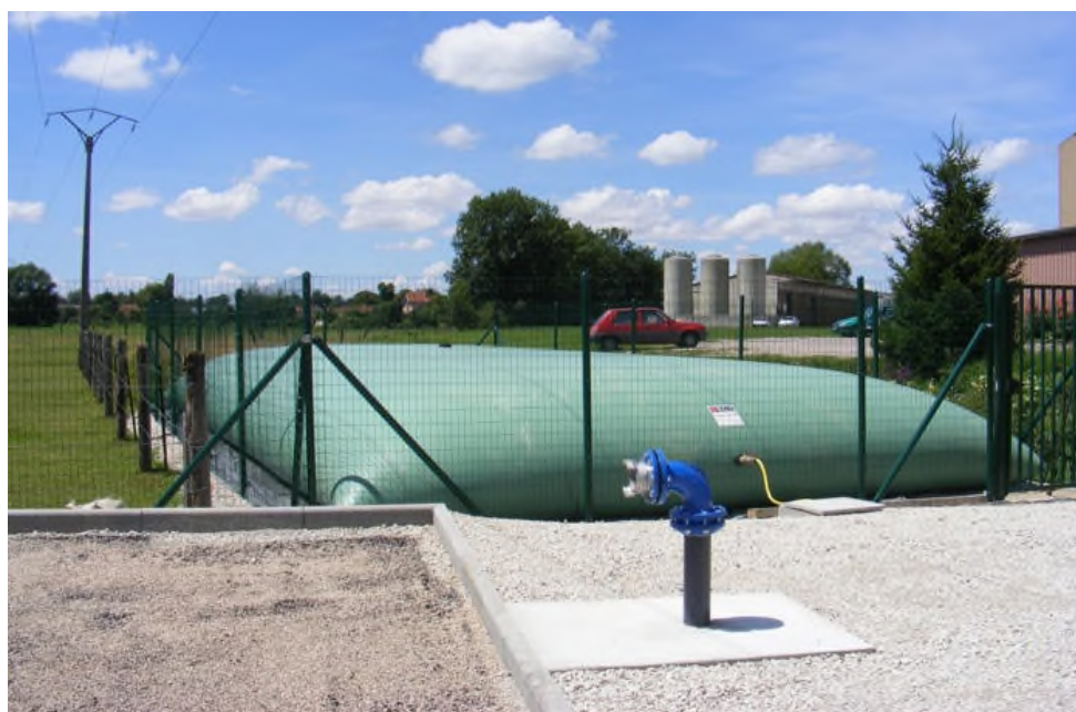
Exemple de réserve incendie hors-gel prévue sur le site
